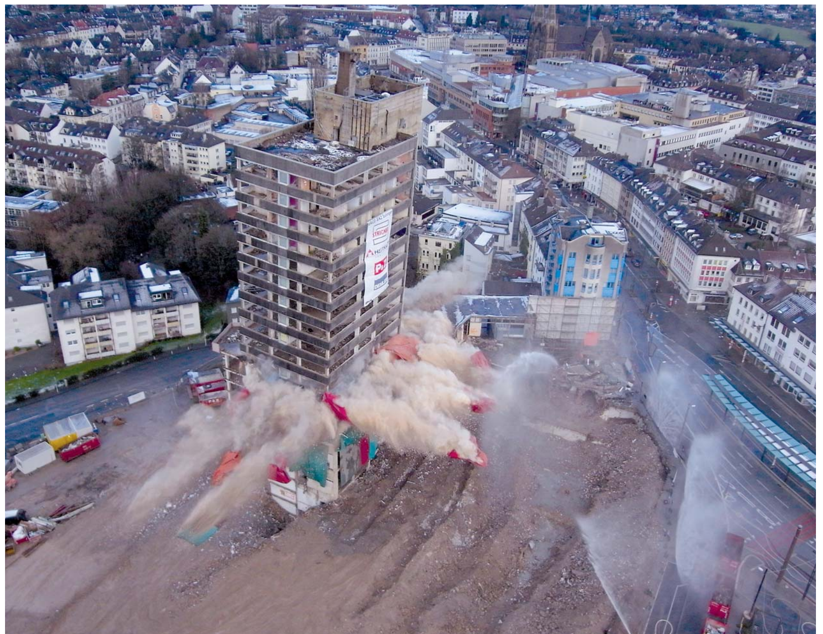
Am 18. Dezember 2011 wurde das 65 m hohe ehemalige Turmhotel – unter Anteilnahme von zahlreichen Zuschauern sowie Funk- und Fernsehen – gesprengt.
