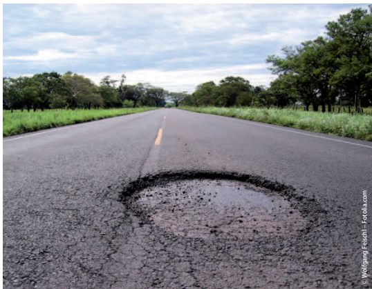
Deutschlands Straßen sind marode – eine Herausforderung für Kommunen und die Baubranche.
