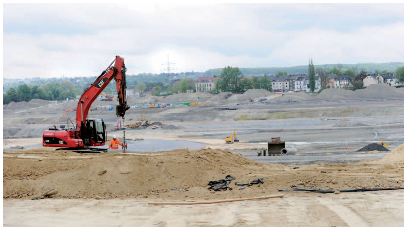
Im Januar 2010 waren der Teilbereich A Entree und das Gewerbegebiet Süd-West fristgerecht fertiggestellt.
